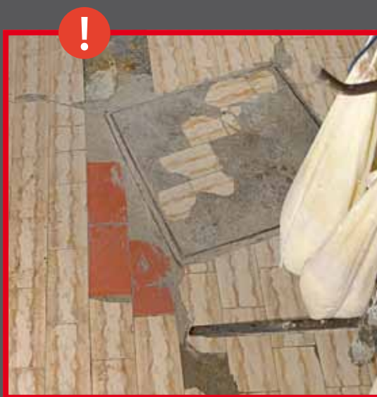
2. Pavimentazione da sistemare
