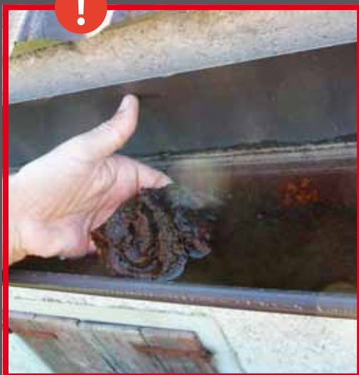
3. Grondaia con ristagno di acqua
