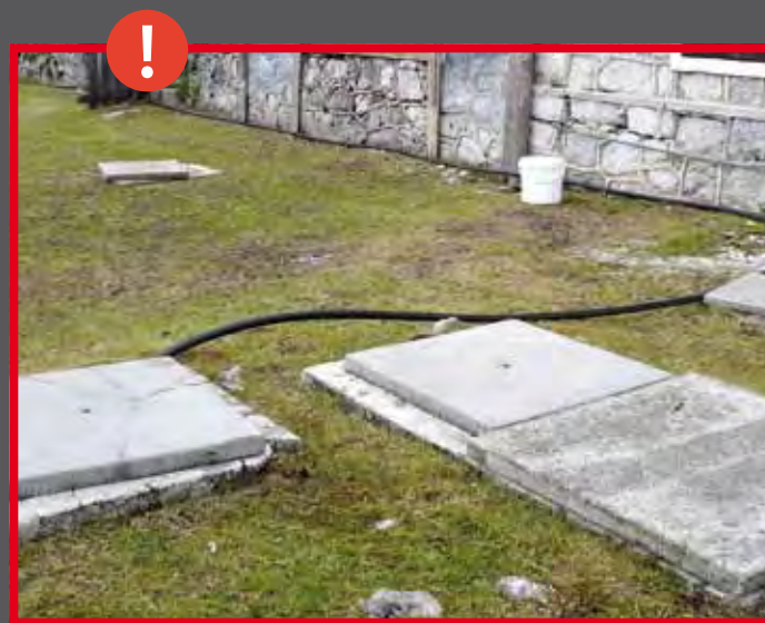
4. Vasche di captazione non protette
