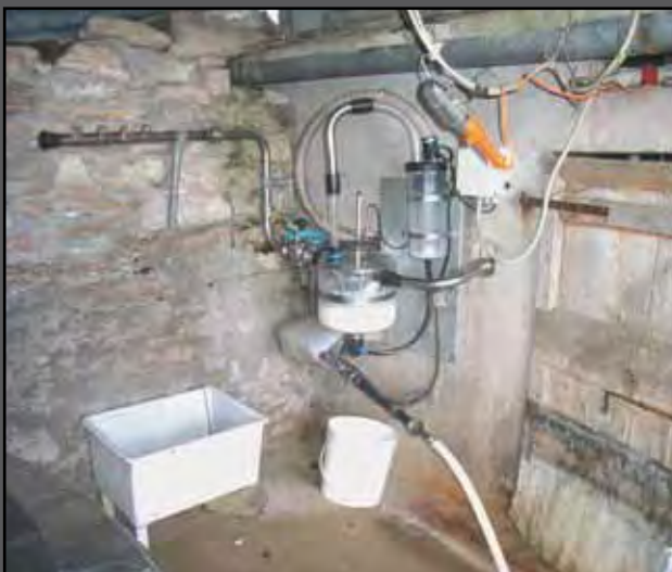
16. Verifica periodica parti meccaniche
